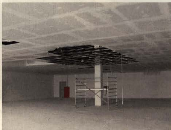
Um Abhängung, Unterkonstruktion und Befestigung prüfen zu können, wurde die Decke geöffnet. (Foto: Schneider)
